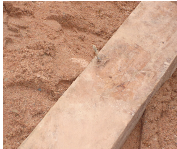
Limpieza de clavos y otros desperdicios de todas las áreas de trabajo.
