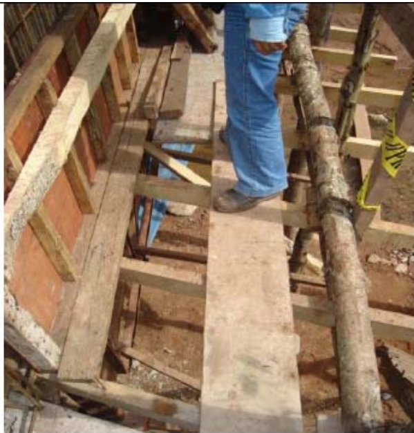
Plataforma con poco espacio de tránsito y con espacios sin cubrir.
